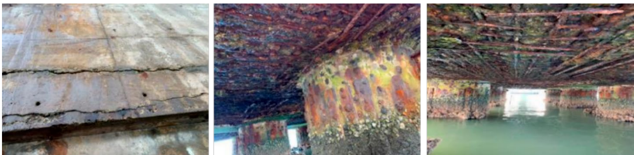
Figura 10 – Patologias no Eixo 7N da Ponte Pedro Ivo Campos (RGM Engenharia (2020)).
