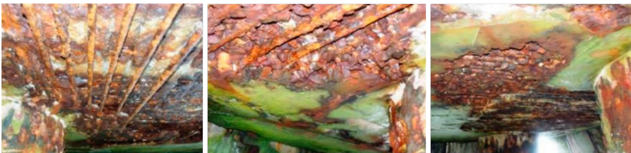
Figura 4 – Patologias no Eixo 6 da Ponte Colombo Machado Salles (RGM Engenharia (2020)).
