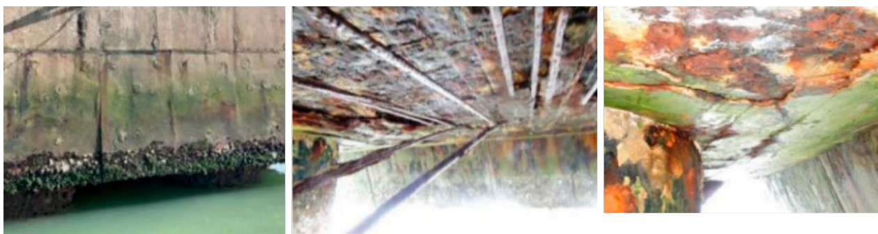
Figura 2 – Patologias no Eixo 4 da Ponte Colombo Machado Salles (Relatório de Inspeções Visuais e Laudo técnico dos blocos de coroamento das Pontes (2020)).
