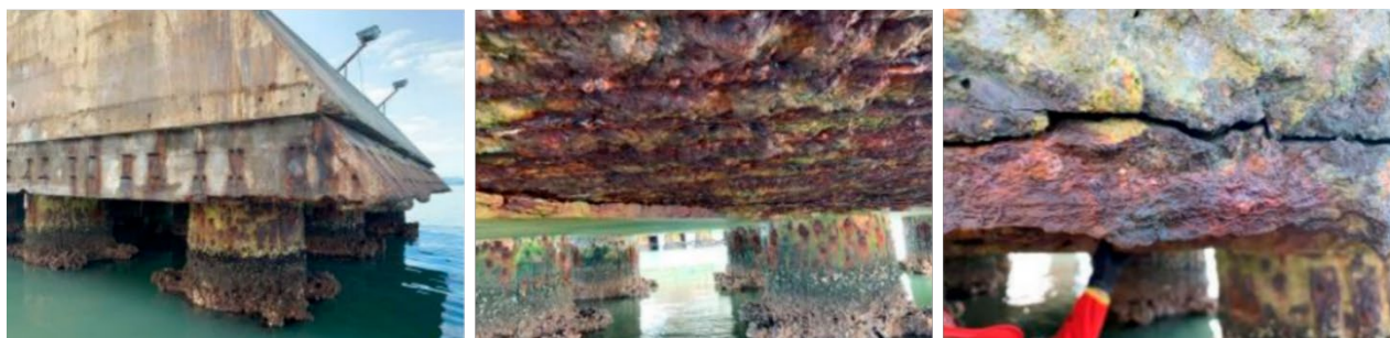
Figura 8 – Patologias no Eixo 7 da Ponte Pedro Ivo Campos (RGM Engenharia (2020)).
