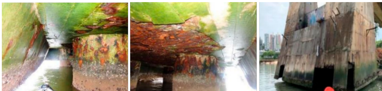
Figura 6 – Patologias no Eixo 6 da Ponte Colombo Machado Salles (RGM Engenharia (2020)).
